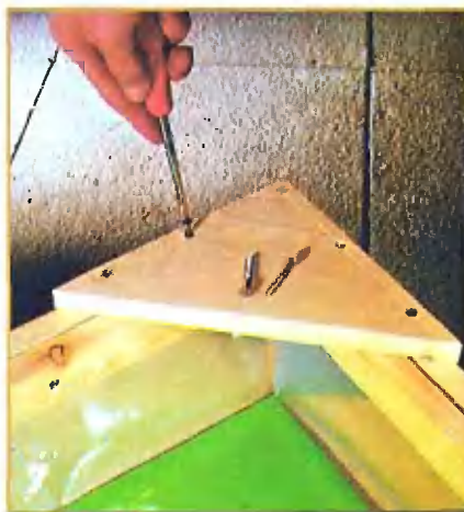
Прикрепив края пленки по периметру фиксирующими планками, к боковым элементам шурупами крепят угловые сиденьца.
